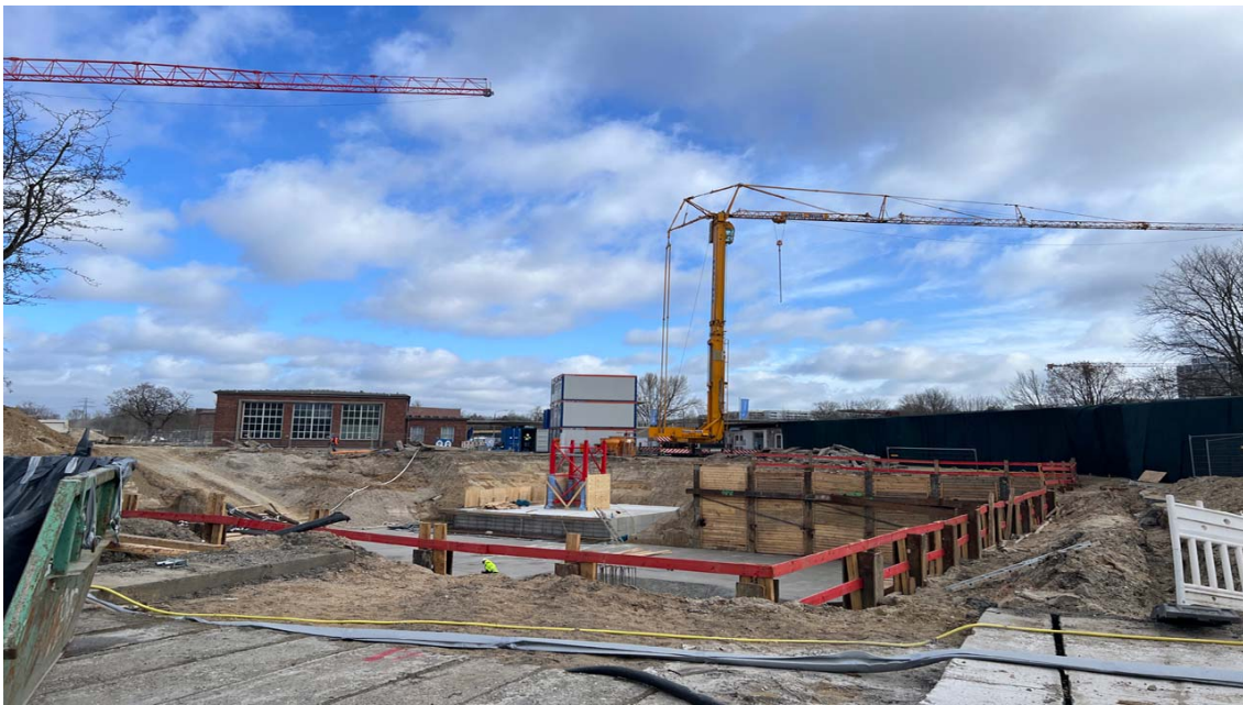
Auf der Baustelle des Neubauprojekts „Konnekt“ in Marzahn entstehen erste Baugruben und Fundamente für den Bau von Wohnungen im ersten Bauabschnitt. / © Foto: ENTWICKLUNGSSTADT
