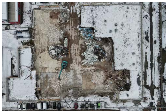
Der Blick von oben auf das Trümmerfeld: Abriss-Bagger stehen inmitten der Ruinen an der Hohensaatener Straße. Stefan Henseke
